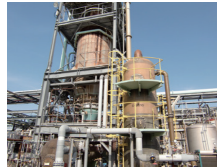
排水熱分解による有機物回収設備（松山工場）
