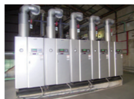
尼崎工場 都市ガスボイラー
