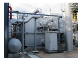
松山工場 水素ボイラー
