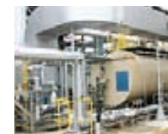
尼崎工場の水素ボイラー(新設)
