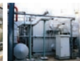
松山工場の水素ボイラー(既設)
