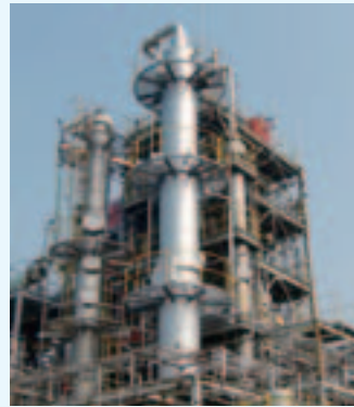
松山工場 アリルグリシジルエーテル製造設備
