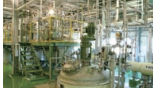
医薬中間体プラント
