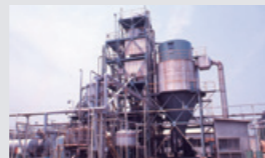
ダップ樹脂製造設備
