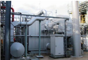
松山工場 水素ボイラー
