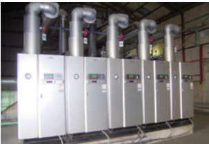
尼崎工場 都市ガスボイラー
