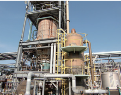
排水熱分解による有価物回収設備 (松山工場)
